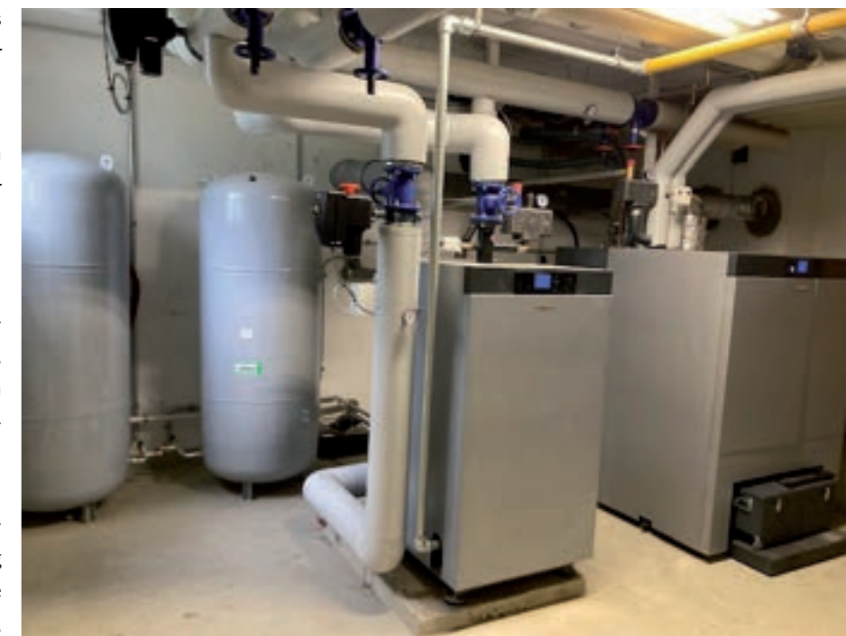
Raiffeisenstr. 13-19, Freiburg, Heizungsanlage
